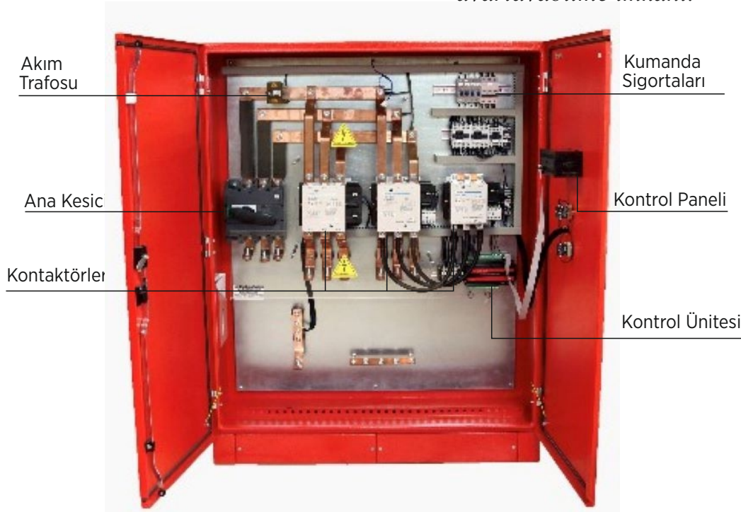
Şekil 4: NFPA 20 Elektrikli Yangın Panosu İç Görünüm
